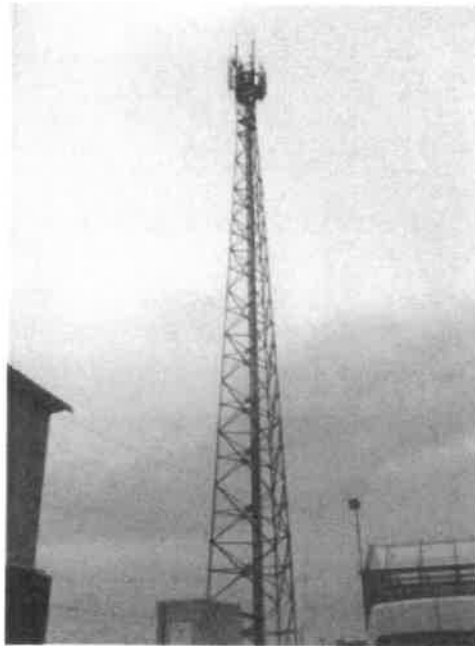
Zał. nr 1: Widok ogólny instalacji radiokomunikacyjnej.
